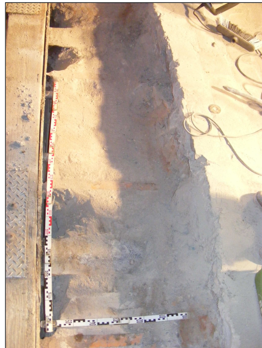
Vista del procés d'afectació del formigó
