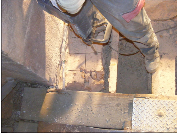
Procés d'afectació de l'estructura del castell UE 5204
