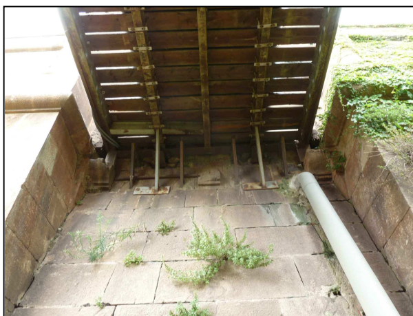
Vista del pont per la banda del castell. S'observen les tres mènsules de sustentació del pont original.
